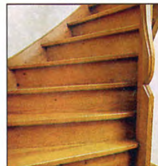
Так выглядела лестница до ремонта. Хотелось уже чего-то нового.
